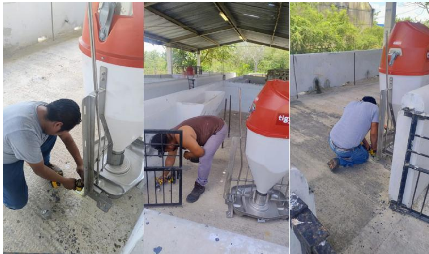
Imagen 19. Instalación de comederos para cerdos. Fuente: Departamento de Mantenimiento de Equipo.
