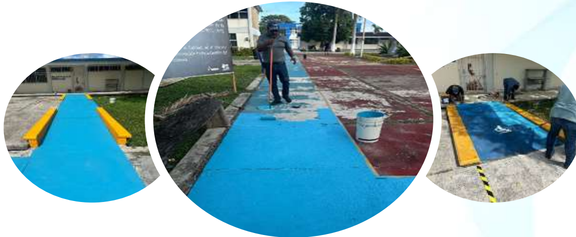
Imagen 42: "Mantenimiento a rampas de personas con discapacidad"
